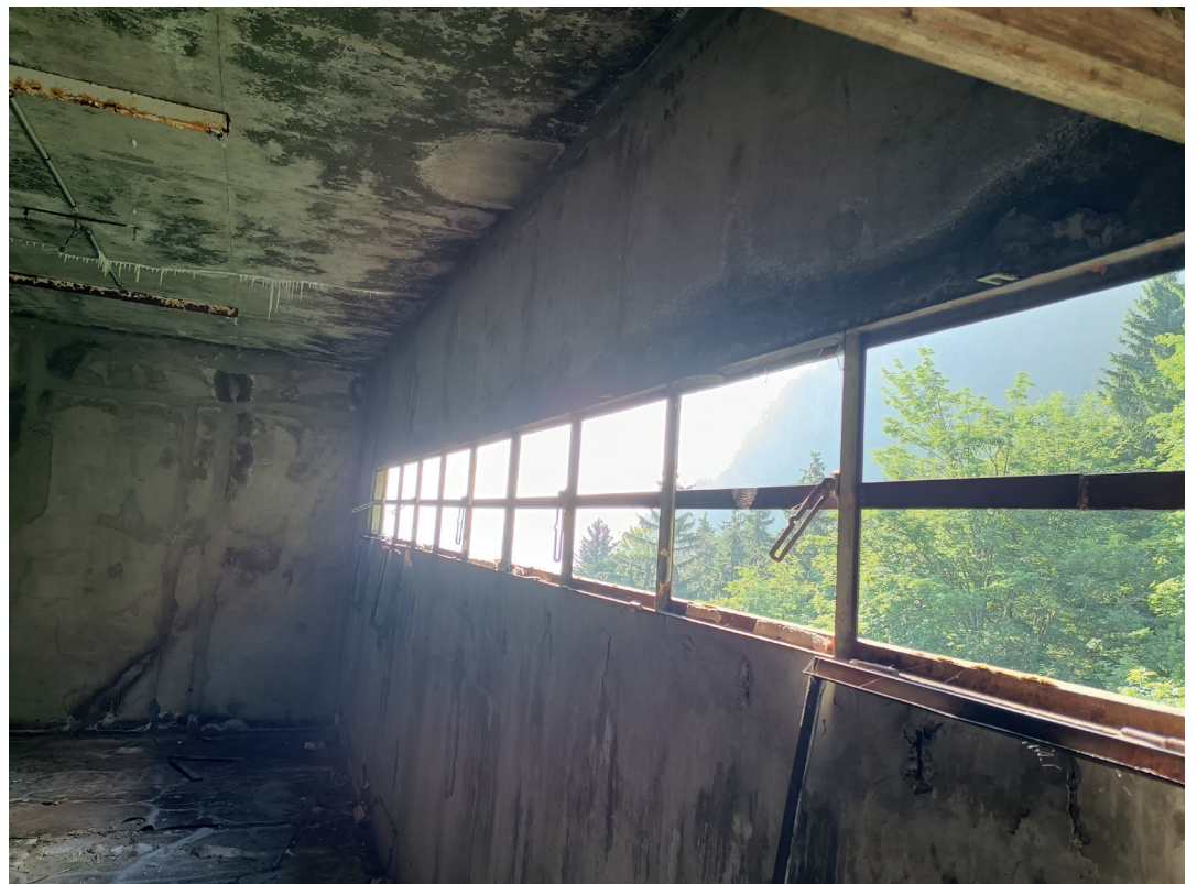
Salle d'organisation. Problème d'étanchéité en toiture, infiltrations existantes depuis longtemps (stalactites). Zones ponctuelles de mise à nu des fers en façades.
