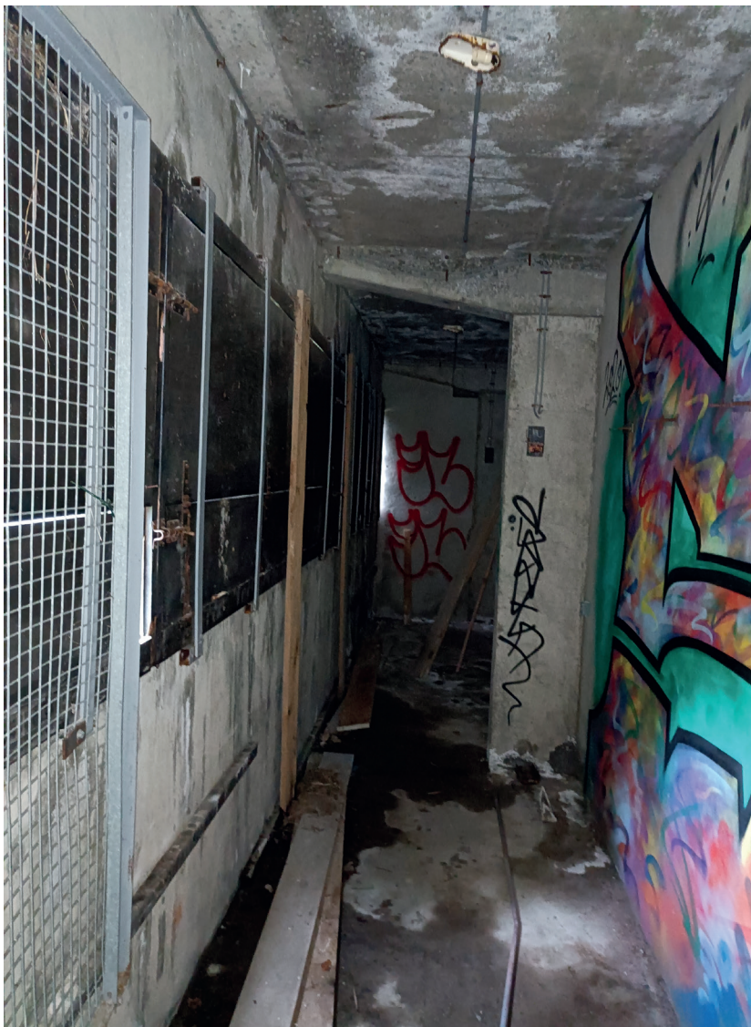
Traces d'efflorescence généralisées en sous dalle. Traces d'humidité.
