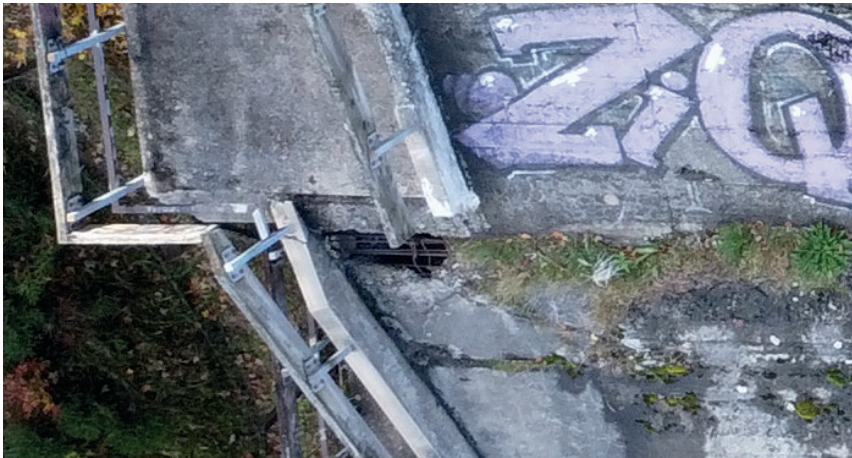
La piste d'élán est perforée sous la plateforme gauche, laissant les armatures apparentes .
