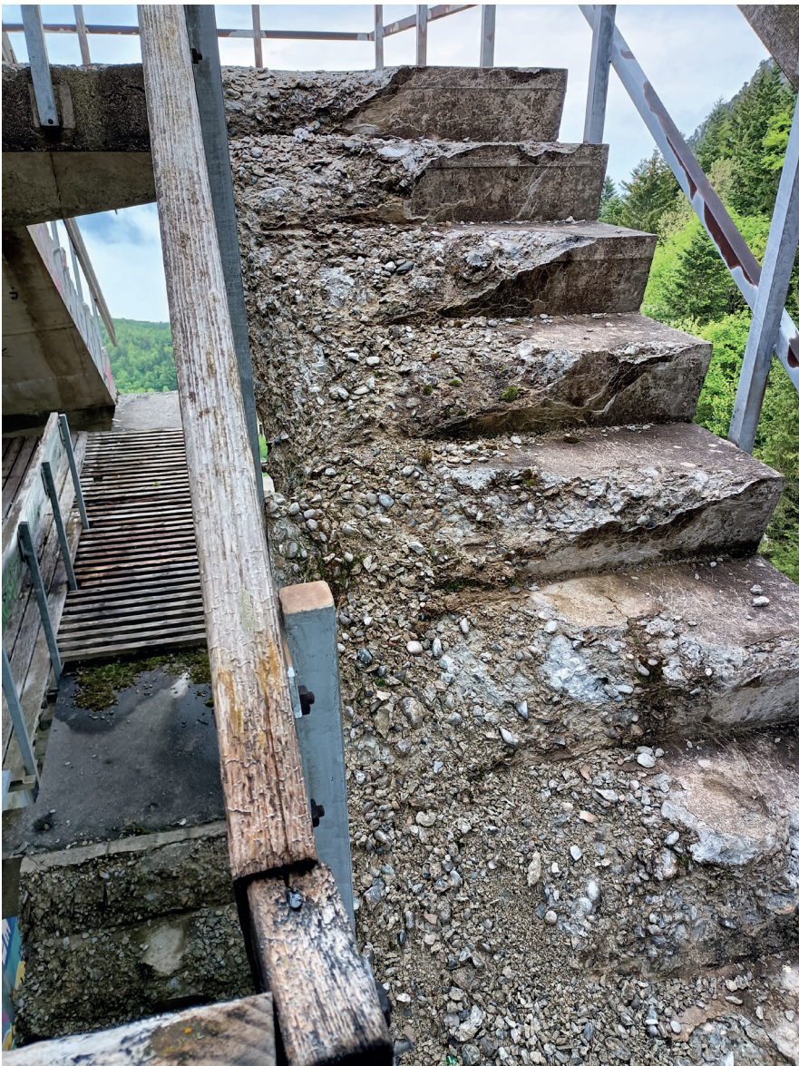
Désagrégation avancée du béton , agrégat très apparent.
