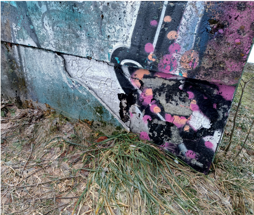
Pied des tribunes officielles. Plaque de béton d'habillage cassée et relevé d'étanchéité mis à nu et qui se désagère à présent.
