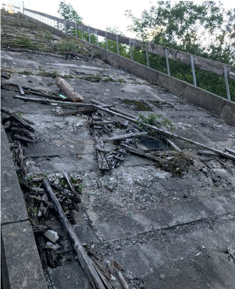
Etat de surface du béton altéré . Présence de débris.
