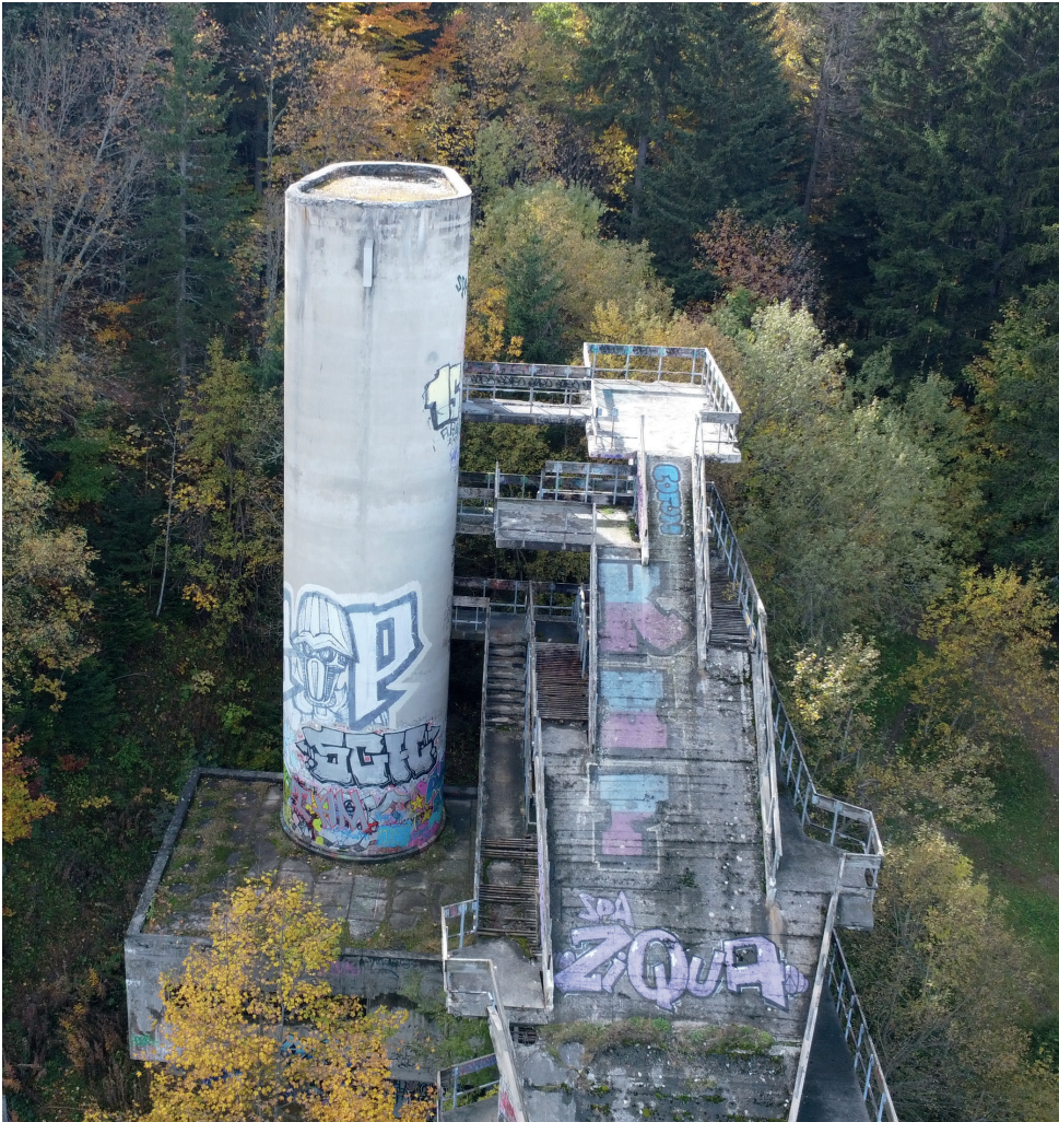
Acrotère de la tour endommagé. Le platelage bois a disparu, et on note la présence de mousse et végétation basse.
