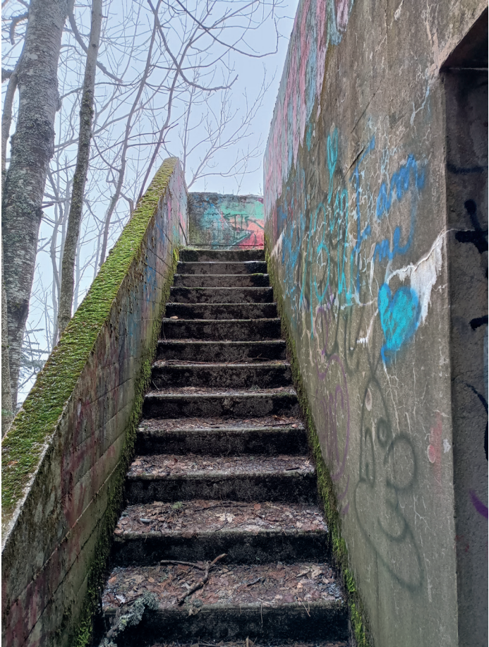
Marches dans un état correct. Zones ponctuelles de fragilité de la couche de surface du béton. Efflorescences.
