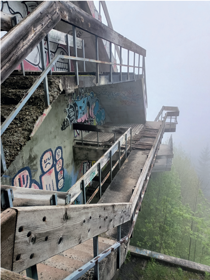
Les plateformes autour du tremplin sont très dégradées. Les armatures sont complètement exposées sur certaines plateformes. L'érosion est beaucoup plus importante au niveau des zones non protégées des intempéries. Le platelage bois est en grande partie manquant, est très détérioré.
