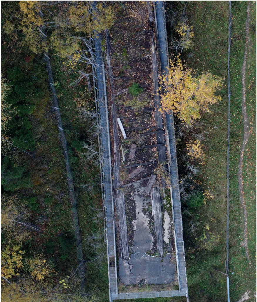
Vue drone de l'extrémité du tremplin. Accumulation de terre et débris. Les restes du platelage bois retiennent la matière organique menant à un développement de la végétation.
