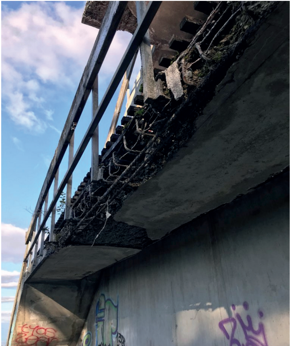
Le béton de surface est décollé et le remplissage s'effrite. Effondrement partiel d'une partie de la dalle, laissant les amatures métalliques complètement dénudées et exposées aux intempéries . Le maintien du garde-corps est fragilisé. Les dommages sont irréversibles, les plateformes sont à reprendre en intégralité.
