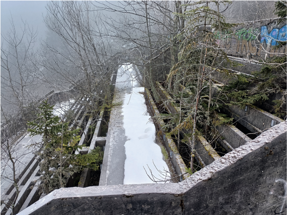
Présence importante de végétation (arbres, arbustes, mousse) sur l'ancienne partie des gradins
