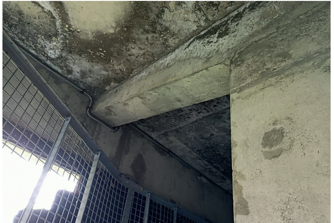
Humidité, efflorescence du béton.
