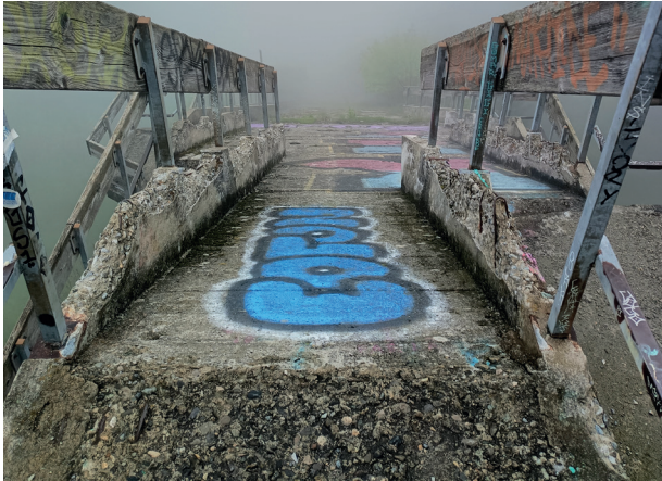
Dégradation avancée du béton, érosion et effritement exposant les armatures. Les bordures sont à reprendre de manière importante, voir complètement. La serrurerie des garde-corps est à reprendre et à traiter contre la corrosion.
